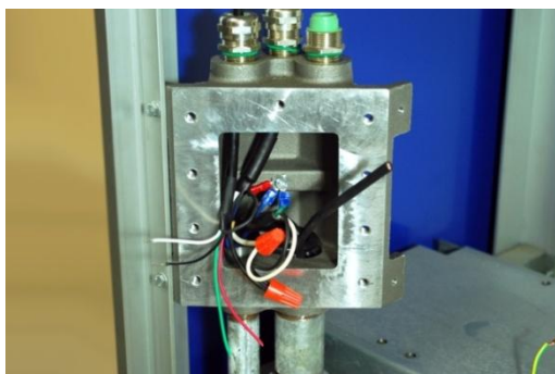
Figura 1 – Caixa de passagem
